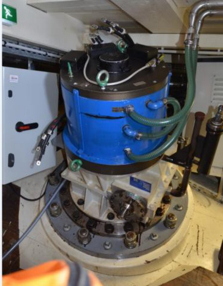
Les moteurs électriques synchrones sont installés dans la cale.
