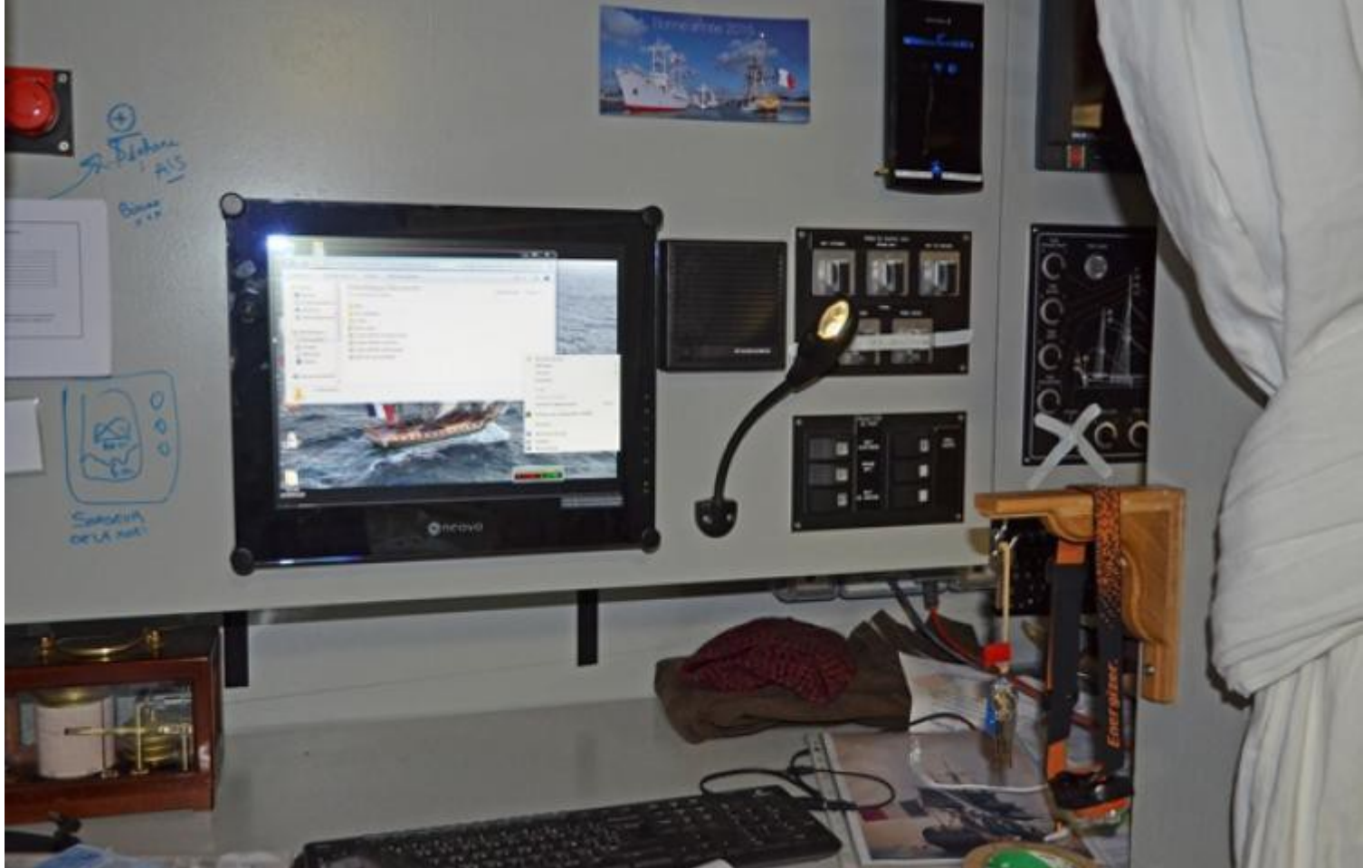
Exemple type de la modernisation de la frégate : la salle de navigation et son matériel électronique.
